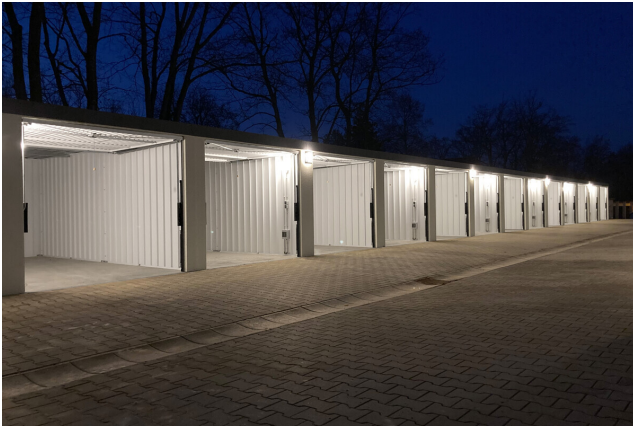
Beispiel Garagenreihe mit Beleuchtung
