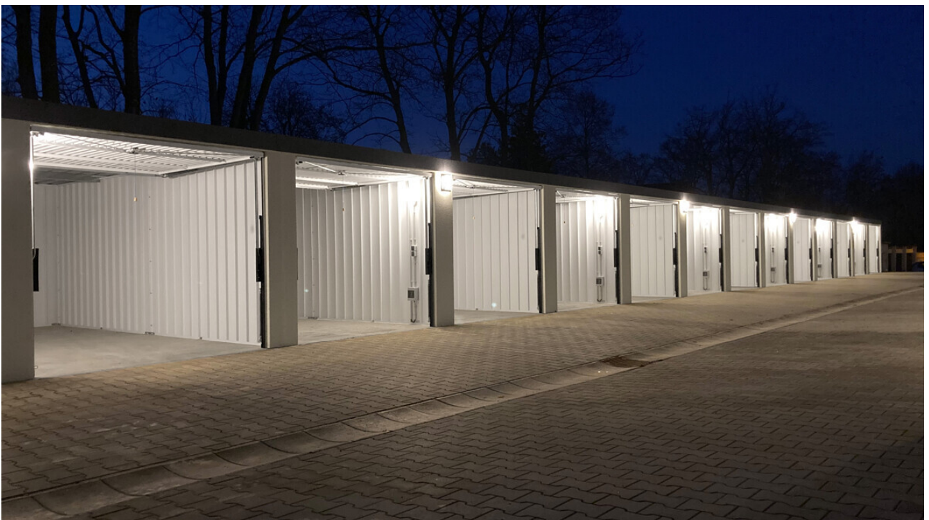
Beispiel Garagenreihe mit Beleuchtung
